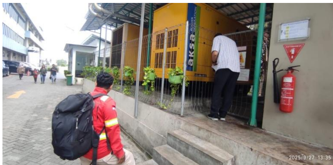
Project Sertifikasi Genset Rs. Hermina , Ciruas, Banten
